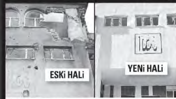
ESKİ HALİ YENİ HALİ İhlâs Camisi'nin dış cephesi roketlerin hedefi oldu.
